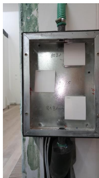
Intérieur du boîtier de mesure avec les 3 capteurs du système de gestion technique du bâtiment
