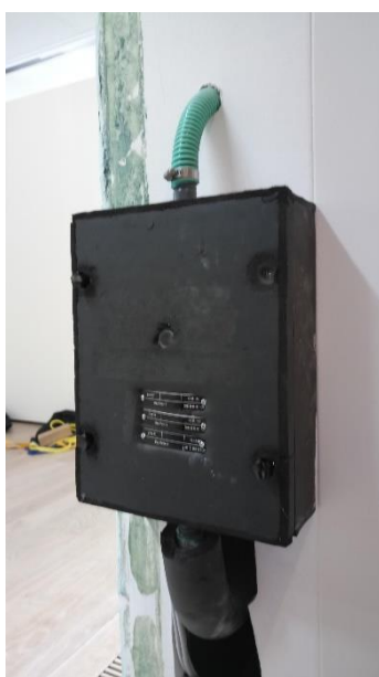
Boîtier de mesure du dispositif dans/derrière la cloison intérieure (fermé)
